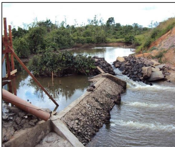
Figura 15 - Unidade de Captação de Água para Abastecimento Público – Córrego Alcebiades
